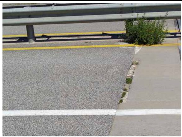
Exp.2 후타재 파손
